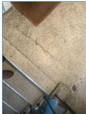
Foto 6: Sætninger på hovedtrappe gulv
