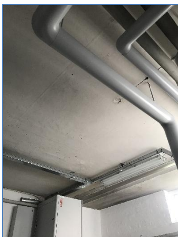
Foto 3: Loft i Kælder
