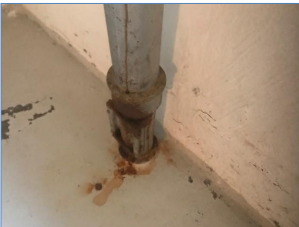
Foto 5: Faldstamme i kælder tæring
