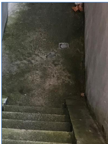
Foto 1: Afløb foran kælderindgang
