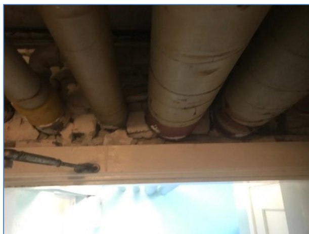
Foto 4: Løst puds over dør i kælder
