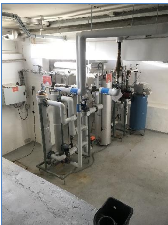
Foto 1: Varmecentral i sin helhed
