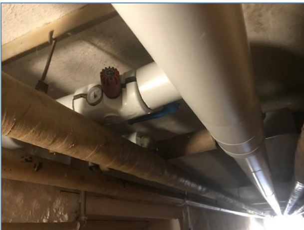
Foto 3: Styringsventiler i kælder
