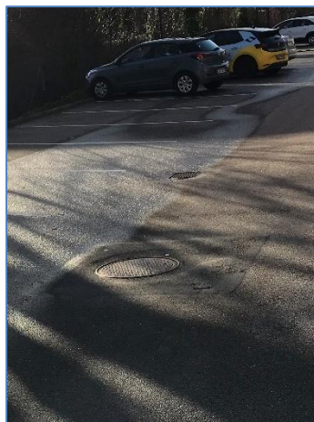
Foto 2: Ristafløb ved parkering ud til gavl
