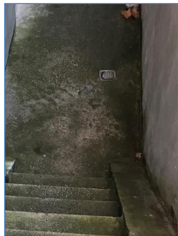
Foto 6: Afløb foran kælderindgang
