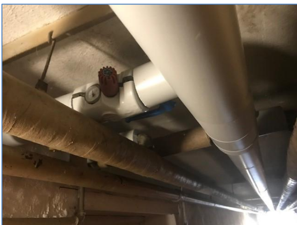
Foto 5: Reguleringsventiler i kælder
